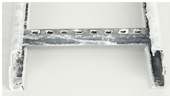
Z4 cable ladder.
